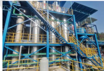
肇庆市新荣昌环保股份有限公司 焚烧废水/氯化铵废水 10T/H三效蒸发器 2套
