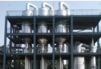
广州国宏新材料有限公司 (久泰集团) 合成纤维单体/聚合物制造 30T/H 三效+单效蒸发系统
