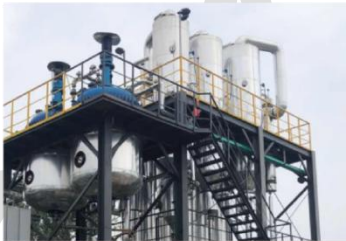
江门新财富环境科技有限公司 物化废水, 焚烧废水 6T/H 三效蒸发器 2套+2T/H双效蒸发器 1套
