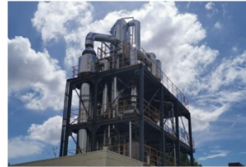
深圳市凯中精密技术股份有限公司 电镀废液 2T/H MVR 蒸发器 1套
