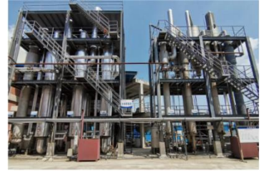
中化环境科技工程有限公司 物化废水, 焚烧废水 15T/H MVR 蒸发器 1套+15T/H 三效 蒸发器 1套
