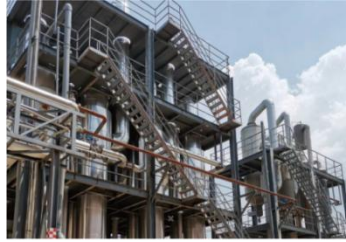
惠州湘澧化工有限公司 氯化铵废水 4T/H三效蒸发器 1套
