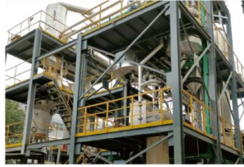
米亚精密金属科技(东莞)有限公司 阳极氧化废水 3T/H MVR 蒸发器 1套+2T/H MVR 蒸发器 2套
