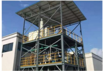
广东新盈信环保科技有限公司 催化剂再生利用废水处理 2T/H MVR 蒸发器 1套
