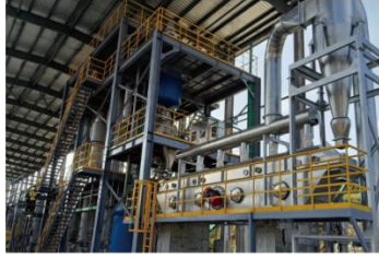
宁德时代新能源科技股份有限公司 氯化锂生产废水处理 10T/H三效蒸发器 1套+2T/H双效蒸发器 1套
